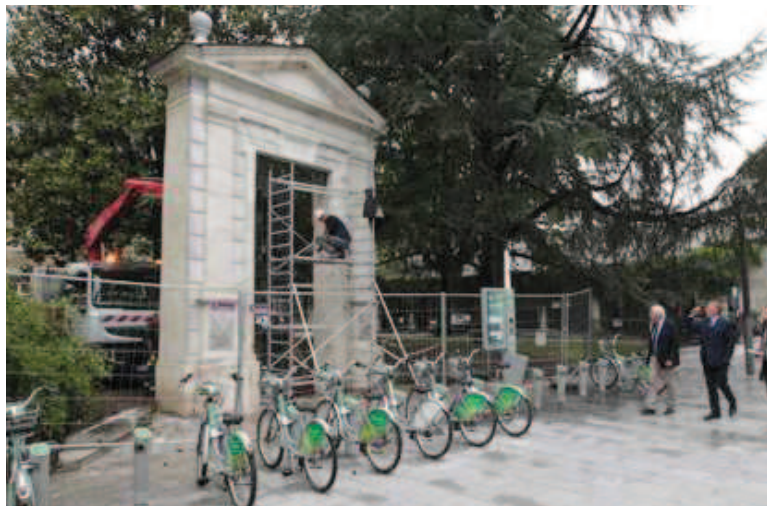
Les travaux se sont achevés ce jeudi. La porte monumentale a été déplacée devant l'entrée historique du lycée Barthou. © MARC ZIRNHELD
